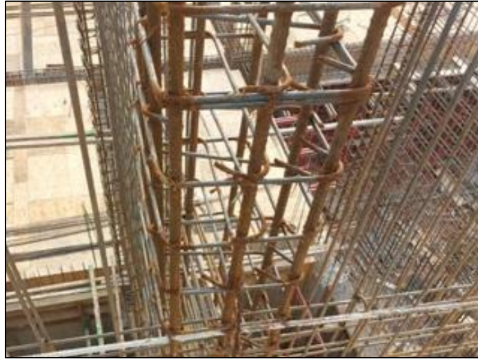
Gambar 3. Tulangan Tabel 4. Presentase Kerusakan
