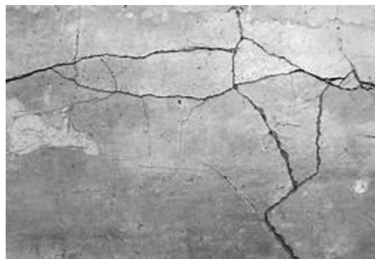
Gambar 2. Retak Pelat Tanpa Wiremesh
